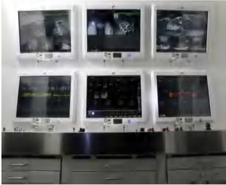
图 4 工作面集中控制室现场监控图
